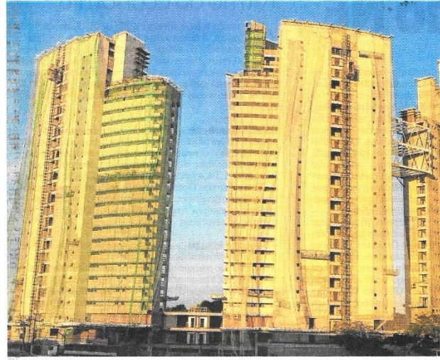
Atualmente, a Prefeitura regula aspectos como o tamanho das janelas e a quantidade de quartos que uma residência deve ter. Com o novo código, não haverá mais isso, dando mais liberdade aos responsáveis pelo projeto FOTO: ANDRÉ COSTA
